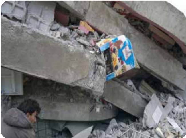
شکل ۴- سازه‌های بلند مرتبه با کیفیت اجرای پایین
